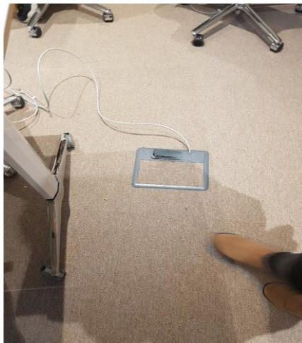
Exemple de câble Ethernet extrait du plancher technique
